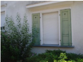
Alte Fensterläden am Gebäude Wulkowstraße, Ecke Niederwallstraße
